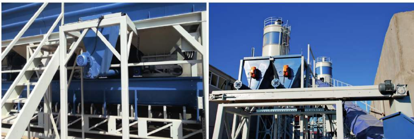
Красители могут дозироваться как на весовой транспортер (слева), так и на конвейер подачи инертных в бетоносмеситель
